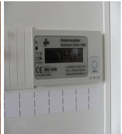
Zähler Infrarotheizung Zählerstand zum 07.03.2013 Verbrauch Winter 756kWh
